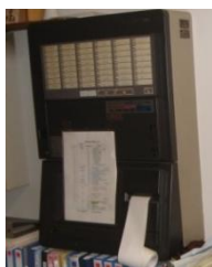
既設中央監視装置
